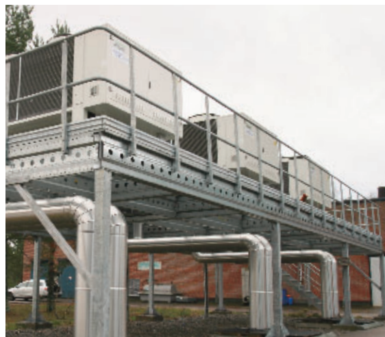
Seksjonsrekkverk i enklere utførelse.
