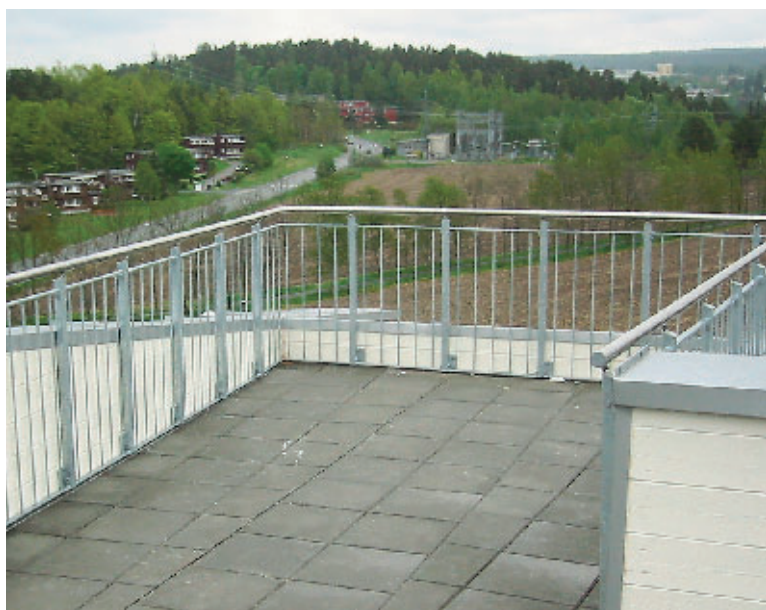
Seksjonsrekkverk med stendere.
